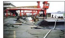
岸壁の裏込め土の流出による地盤沈下
