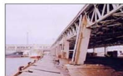
基礎の水平移動に伴う柱の倒れ
