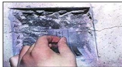
躯体コンクリートのひびわれ
