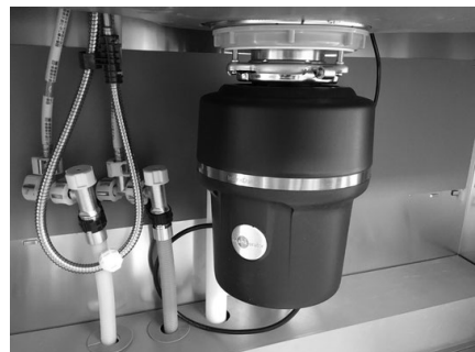
▲シンク内に設置した生物処理タイプ
